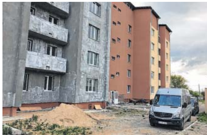
Renovierung: Dieser Plattenbau soll zum Gemeindehaus umgebaut werden. Die linke Gebäudehälfte ist renoviert.
