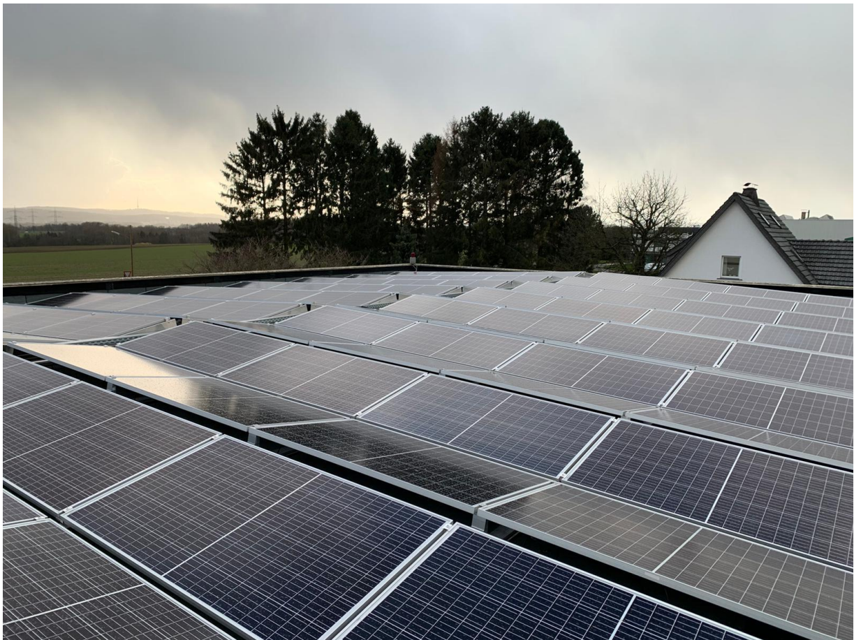
Abbildung 4 Dachfläche mit PV-Anlage
